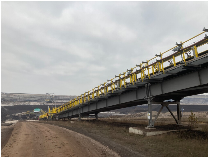
Stationäre Bandanlage Fotograf/Urheber: Nils Schinker
