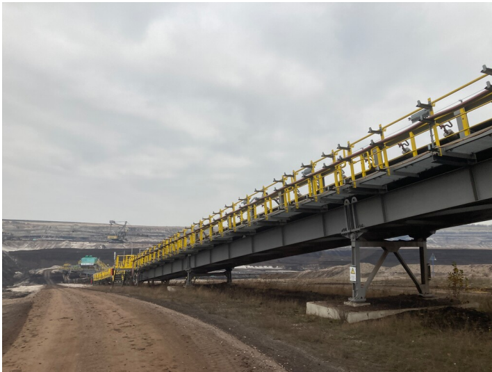
Stationäre Bandanlage Fotograf/Urheber: Nils Schinker
