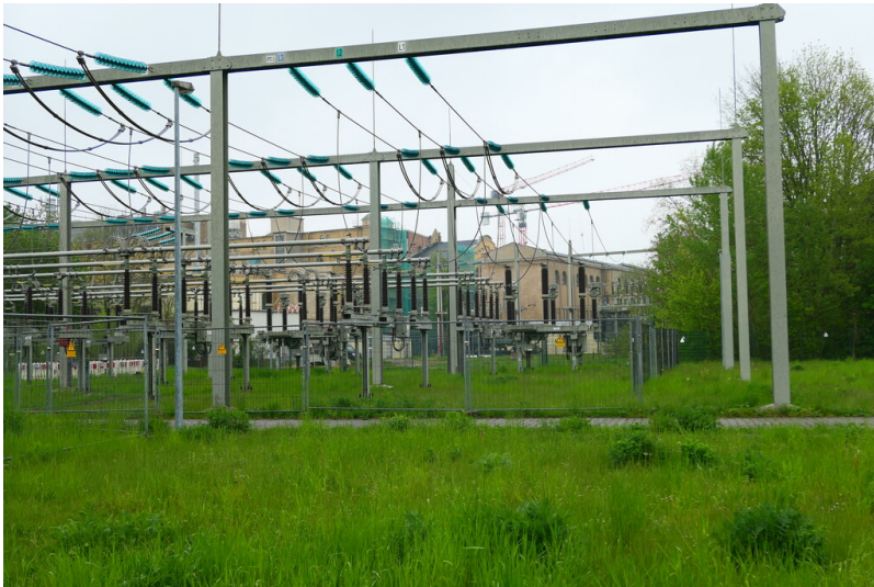
östlicher Bereich der Umspannanlage mit Blick Richtung Norden Fotograf/Urheber: Corinna Wobbe
