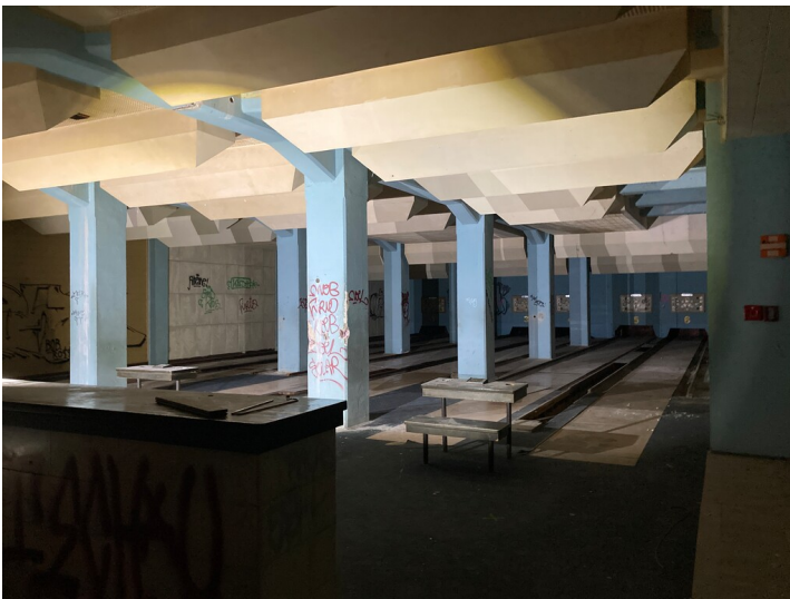
Umspannwerk bzw. Unterwerk Moritzdamm, Akkumulatorenhalle (Ost) Fotograf/Urheber: Isabell Schmock-Wieczorek
