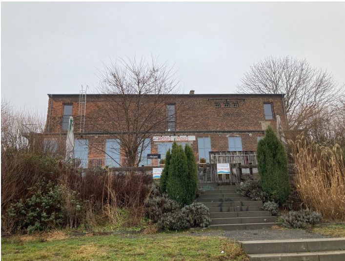
Transformatorstation Westseite (Seeseite) Fotograf/Urheber: Isabell Schmock-Wieczorek
