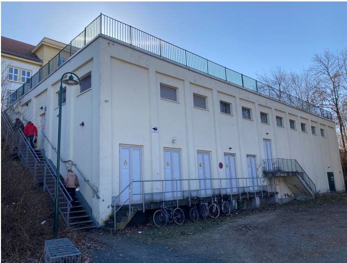
Umformstation Krankenhaus Borna aus nordwestlicher Richtung Fotograf/Urheber: Isabell Schmock-Wieczorek
