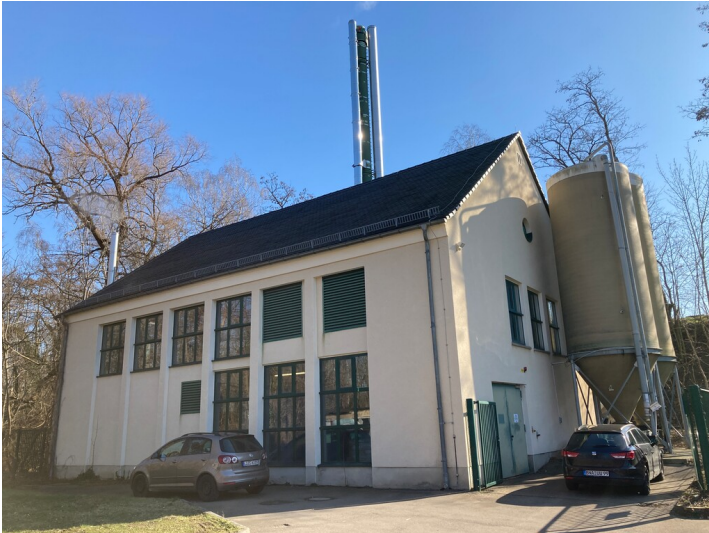
Dampfübergabestation Krankenhaus Borna Fotograf/Urheber: Isabell Schmock-Wieczoreck
