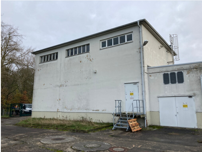
Pumpstation an der Geschiebefalle Kleindalzig, Blick in Richtung Osten Fotograf/Urheber: Nils Schinker
