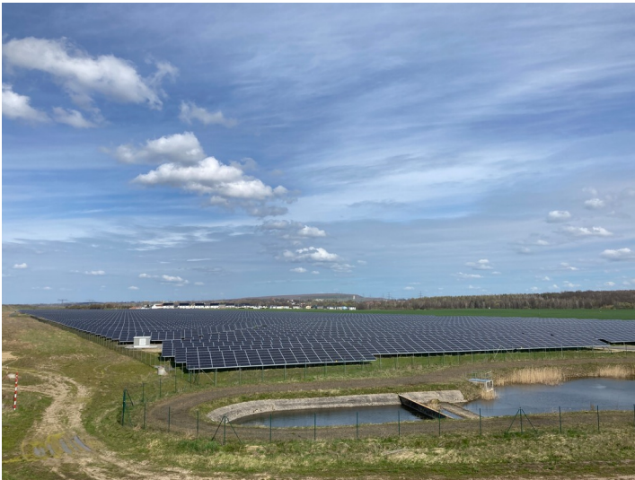
Solkraftwerk auf ehemaligem Tagebaugelände, Blick in Richtung Norden Fotograf/Urheber: Vincent Haburaj
