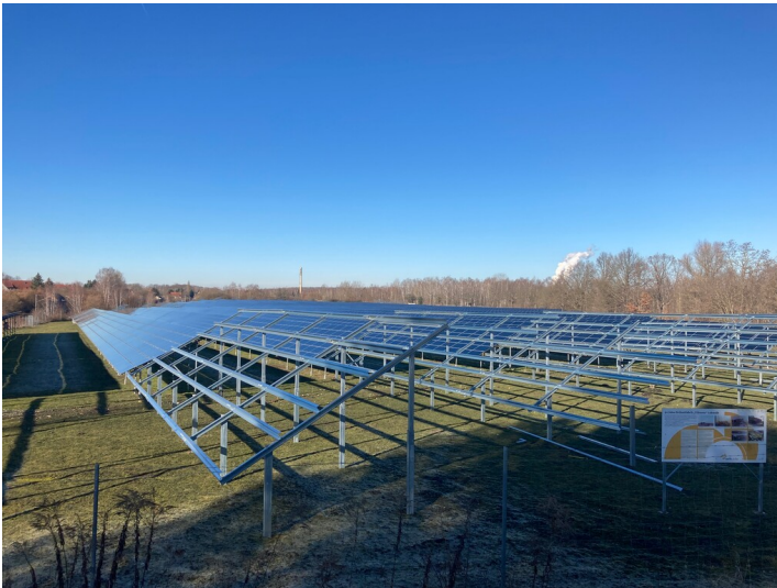
Solkraftwerk auf ehemaligem Brikettfabriksgelände, Blick in Richtung Norden Fotograf/Urheber: Vincent Haburaj
