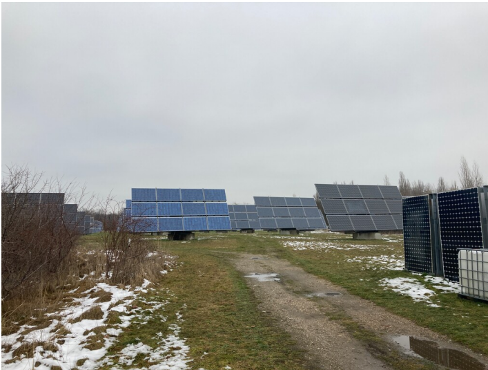
Solarstromkraftwerk auf ehemaligem Brikettfabriksgelände, Blick in Richtung Nordosten Fotograf/Urheber: Vincent Haburaj
