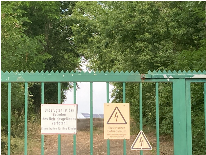
Solarkraftwerk auf ehemaliger Kohlestaubdeponie, Blick in Richtung Norden Fotograf/Urheber: Vincent Haburaj
