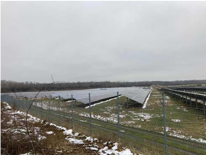
Blick über das Solarkraftwerk in Richtung Osten Fotograf/Urheber: Vincent Haburaj
