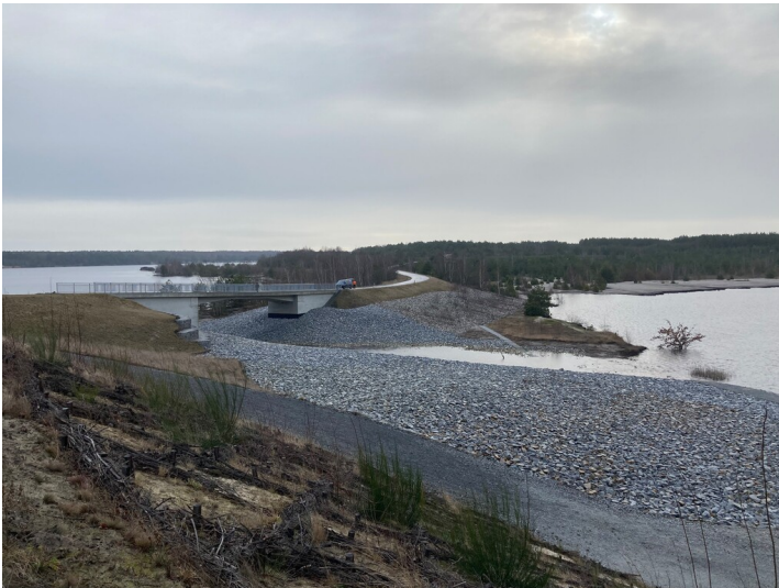
Überleiter zwischen Sabrodter See und Blunoer See mit Brücke Fotograf/Urheber: Nora Wiedemann
