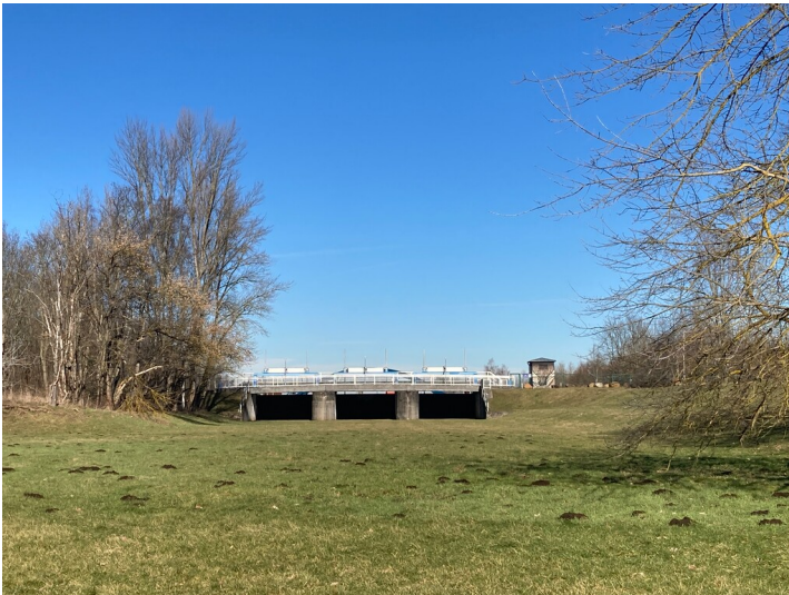
Zulauf Rückhaltebecken Stöhna, Blick von der Pleiße aus in Richtung Norden Fotograf/Urheber: Vincent Haburaj
