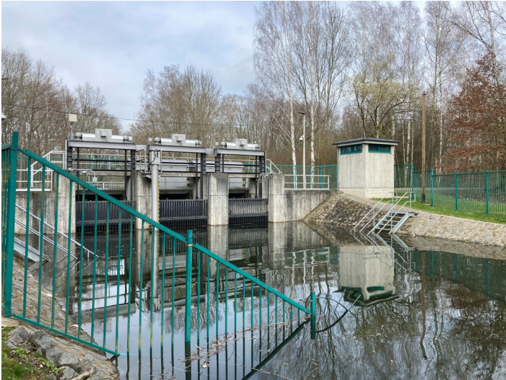
Auslaufbauwerk Speicherbecken Witznitz mit Ausleitgraben, Blick in Richtung Norden Fotograf/Urheber: Vincent Haburaj
