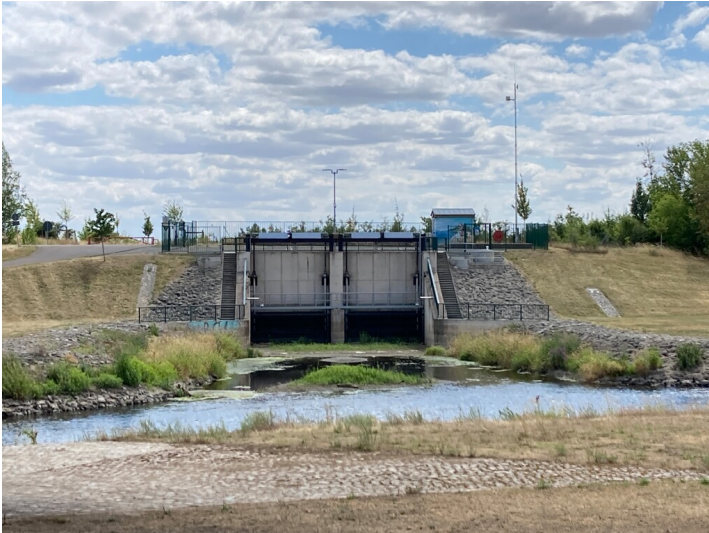
Auslaufbauwerk mit Weißer Elster im Vordergrund Fotograf/Urheber: Vincent Haburaj
