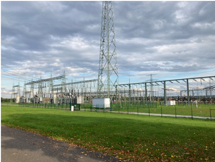
Umspannwerk mit Gleisanlage, Transformatoren und Schaltanlagen Fotograf/Urheber: Josephine Dressler
