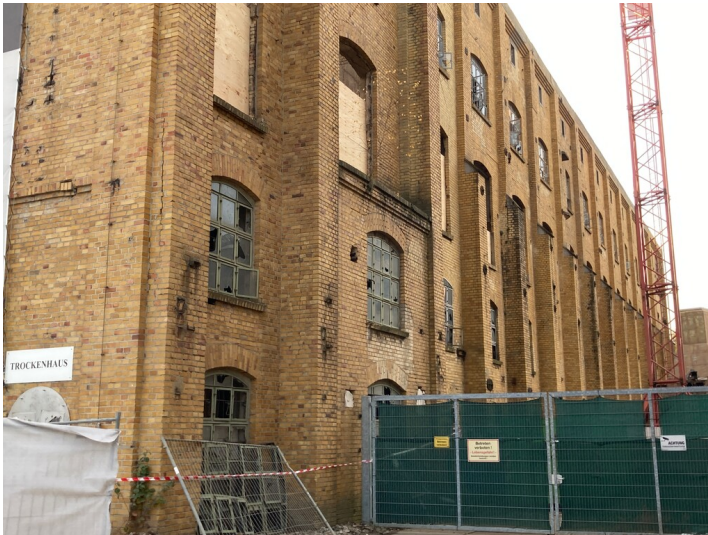
Trockendienst der ehemaligen Brikettfabrik Witznitz, Blick von Osten auf Nordfassade Fotograf/Urheber: Josephine Dressler
