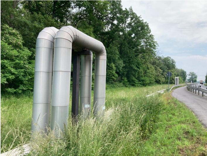
Fernwärmeleitung, Blick nach Südosten entlang der S 71 in Richtung Neukieritzsch Fotograf/Urheber: Nils Schinker
