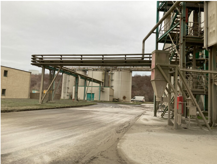
Tagebau Vereinigtes Schleenhain, Restwasserbehälter und Pumpenhaus, Blick nach Nordost Fotograf/Urheber: Nils Schinker
