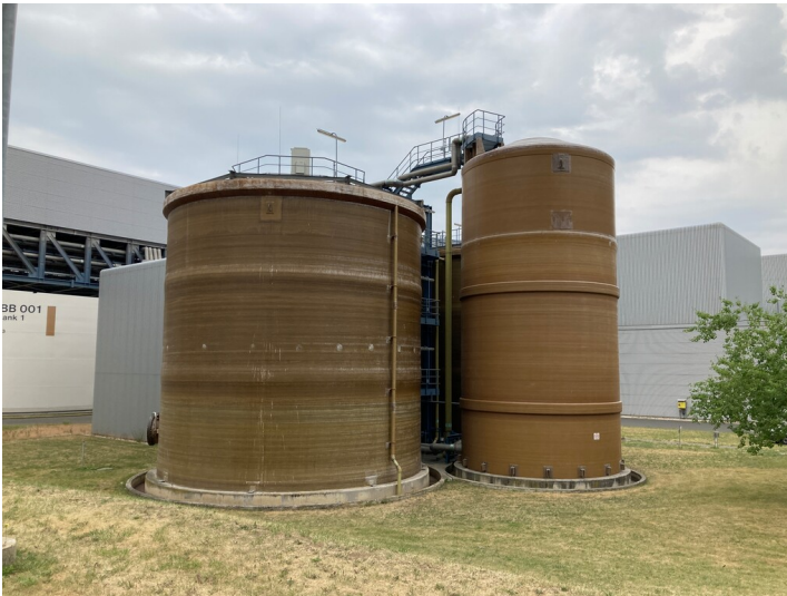
Kraftwerk Lippendorf, Behälter für Ausschleuswasser, Blick nach Nordost Fotograf/Urheber: Josephine Dressler
