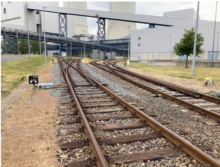
Kraftwerk Lippendorf, Gleisanlagen auf dem Kraftwerksgelände, Blick von Südost Fotograf/Urheber: Josephine Dressler
