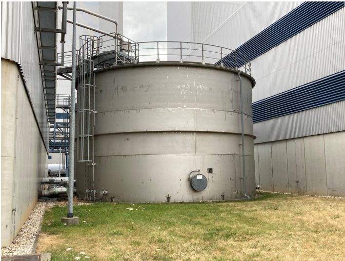
Kraftwerk Lippendorf, Deionattank Fotograf/Urheber: Josephine Dressler
