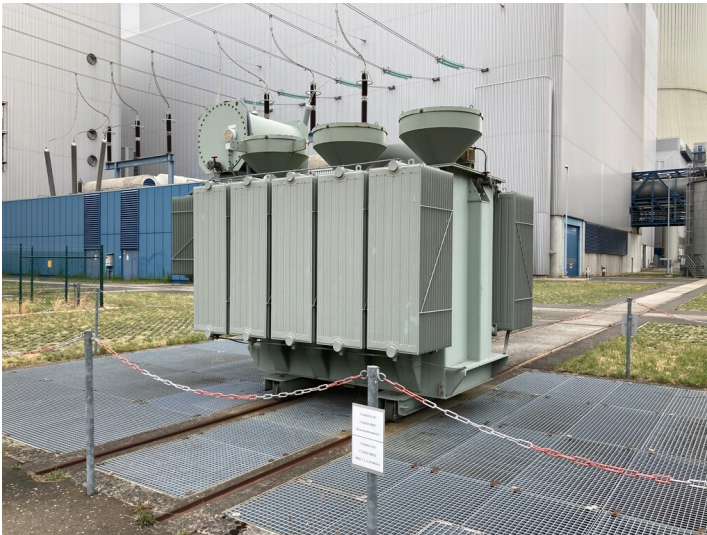
Kraftwerk Lippendorf, mobiler Fremdnetz-Trafo auf Gleisen und Absetzfundamenten, Blick von Südost Fotograf/Urheber: Josephine Dressler
