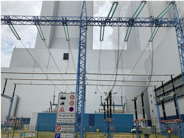
Kraftwerk Lippendorf, Maschinenabspannfeld der 380-kV-Umspannanlage, Blick von Süden Fotograf/Urheber: Josephine Dressler
