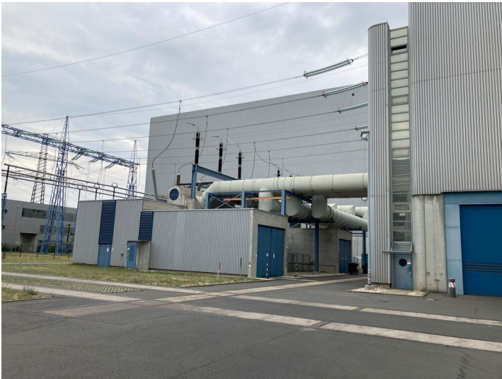
Kraftwerk Lippendorf, Umspannstation 380-kV-Anlage, Blick von Nordost Fotograf/Urheber: Nils Schinker
