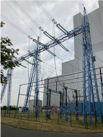
Kraftwerk Lippendorf, Maschinenabspannfeld der 380-kV-Umspannanlage, Blick nach Norden Fotograf/Urheber: Josephine Dressler
