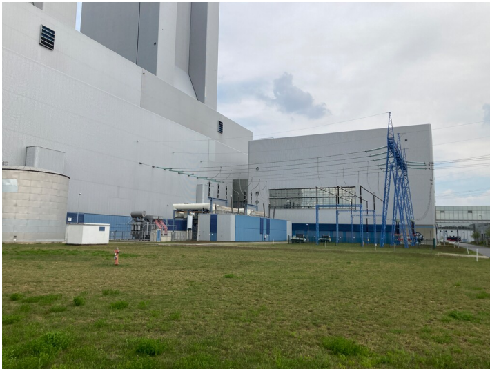
Kraftwerk Lippendorf, Umspannstation 380-kV-Anlage, Blick von Südwest Fotograf/Urheber: Nils Schinker
