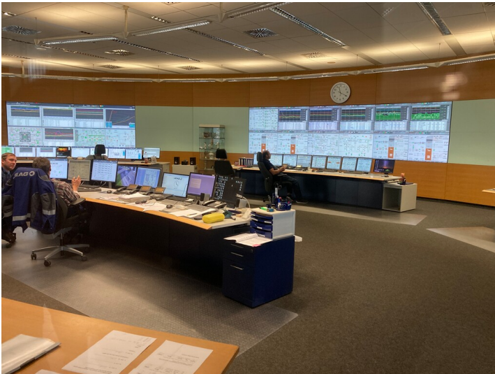
Kraftwerk Lippendorf, Schaltanlagegebäude der Hauptanlage, Leitstand für beide Kraftwerksbetreiber Fotograf/Urheber: Nils Schinker
