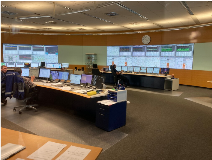
Kraftwerk Lippendorf, Schaltanlagegebäude der Hauptanlage, Leitstand für beide Kraftwerksbetreiber Fotograf/Urheber: Nils Schinker
