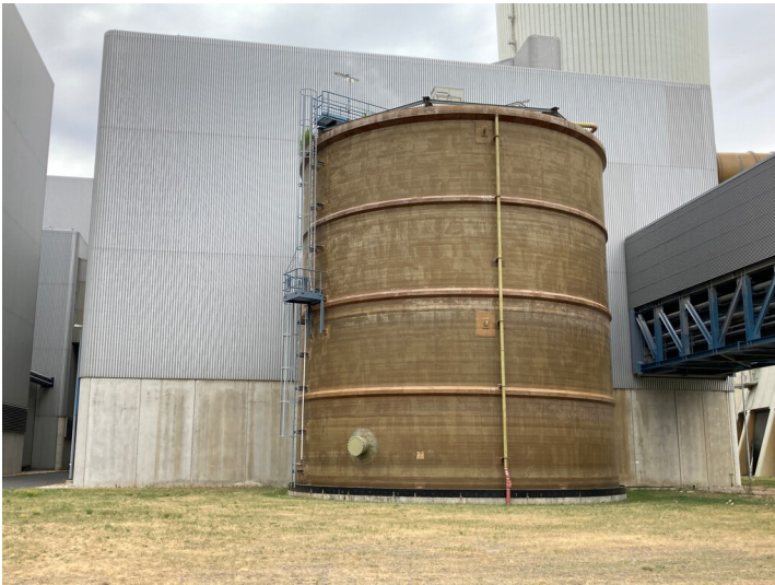
Kraftwerk Lippendorf, Entleerungsbehälter an Ostseite der Rauchgasentschwefelungsanlage Fotograf/Urheber: Josephine Dressler
