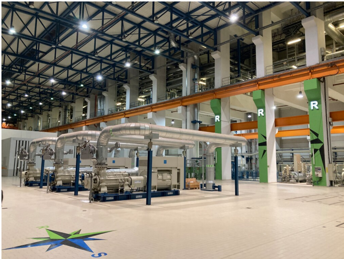
Kraftwerk Lippendorf, westlicher Teil (Block R) des Maschinenhauses, Turbinenhalle mit Kranbahn Fotograf/Urheber: Nils Schinker
