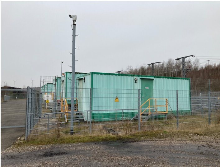
Tagebau Vereinigtes Schleenhain, Umspannstation Abbaufeld Schleenhain Fotograf/Urheber: Nils Schinker
