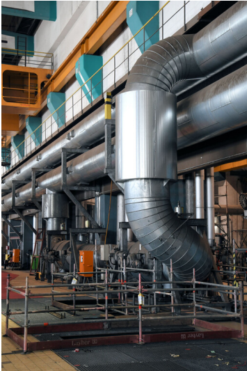
Kraftwerk Weisweiler: Führung der Dampfleitungen entlang der Nordwand des Maschinenhauses; Foto: 16.06.2023 Fotograf/Urheber: Dr. Norbert Gilson
