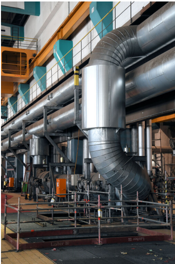
Kraftwerk Weisweiler: Führung der Dampfleitungen entlang der Nordwand des Maschinenhauses; Foto: 16.06.2023 Fotograf/Urheber: Dr. Norbert Gilson
