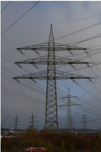
Kraftwerk Weisweiler: Abspannmast M 1 (BI-Nr. 1299) mit Aufnahme der 110-kV-Abgänge ""Weisweiler-G3"" und ""Weisweiler-H3"" aus der Schaltanlage Zukunft, Ansicht von Süden; Foto: 22.11.2023 Fotograf/Urheber: Dr. Norbert Gilson
