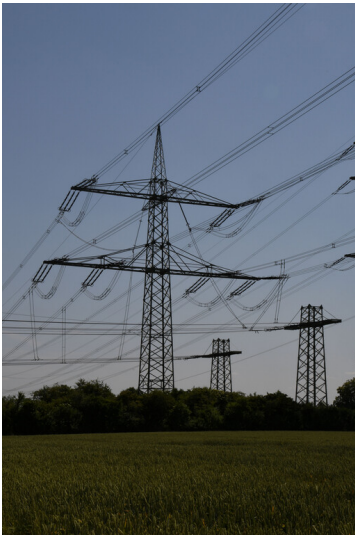
Kraftwerk Weisweiler: Freileitungsabgang Block H, Abspannmast M 106A (Mitte) und Freileitungsmast M 106 (links) mit 380-kV-Leitung (Bl-Nr. 4514) zur Umspannanlage Oberzier, Ansicht von Nordwesten; Foto: 16.06.2023 Fotograf/Urheber: Dr. Norbert Gilson
