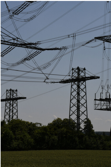
Kraftwerk Weisweiler: Freileitungsabgang Block G, Führung der Leitungsseile auf Abspannmast M 106B, Ansicht von Nordwesten; Foto: 16.06.2023 Fotograf/Urheber: Dr. Norbert Gilson
