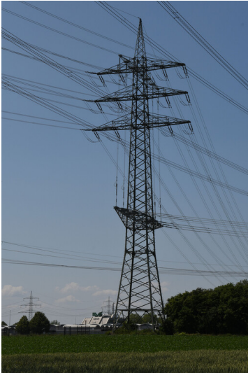
Kraftwerk Weisweiler: Freileitungsabgang 110 kV Block F, Führung der Leitungseile auf Mast M 6 der 110-kV-Leitung (BI-Nr. 1299), Ansicht von Osten; Foto: 16.06.2023 Fotograf/Urheber: Dr. Norbert Gilson
