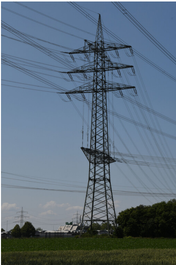
Kraftwerk Weisweiler: Freileitungsabgang 110 kV Block F, Führung der Leitungseile auf Mast M 6 der 110-kV-Leitung (BI-Nr. 1299), Ansicht von Osten; Foto: 16.06.2023 Fotograf/Urheber: Dr. Norbert Gilson
