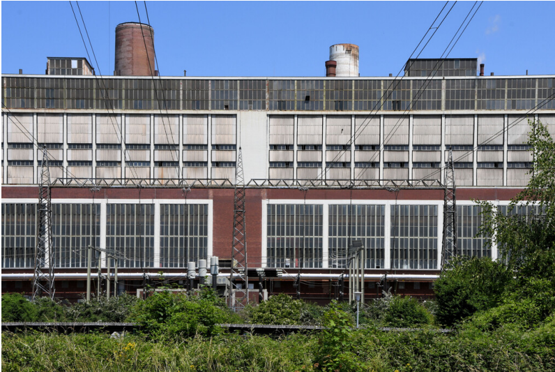
Kraftwerk Weisweiler: Anschlussleitungen vom Portalgerüst der Freiluft-Schaltanlage Block E zur Hochspannungsleitung, Ansicht von Nordosten; Foto: 16.06.2023 Fotograf/Urheber: Dr. Norbert Gilson
