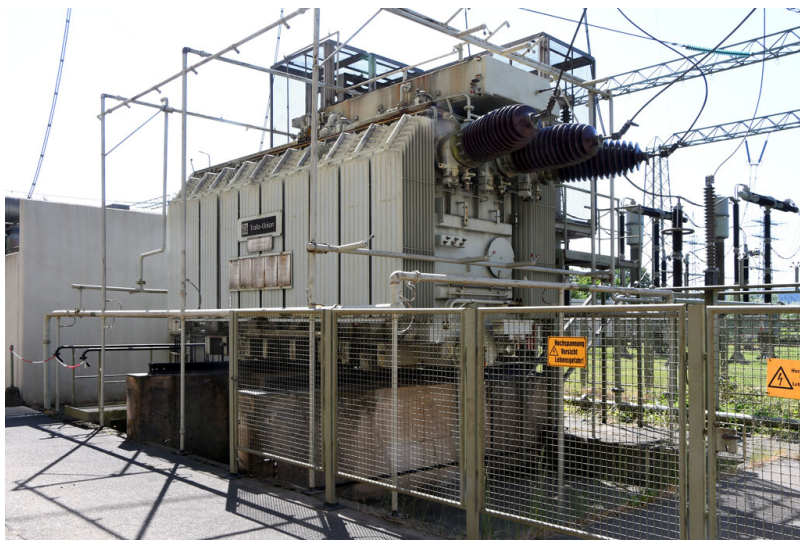
Kraftwerk Weisweiler: Anfahrtrafo 12 Blöcke G/H, 110/21 kV, 40 MVA, Ansicht von Nordwesten; Foto: 13.06.2023 Fotograf/Urheber: Dr. Norbert Gilson
