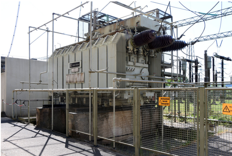
Kraftwerk Weisweiler: Anfahrtrafo 12 Blöcke G/H, 110/21 kV, 40 MVA, Ansicht von Nordwesten; Foto: 13.06.2023 Fotograf/Urheber: Dr. Norbert Gilson
