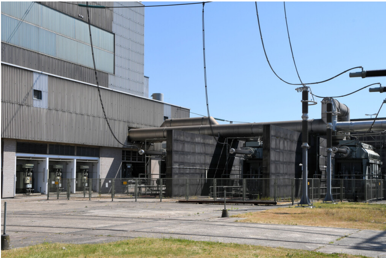
Kraftwerk Weisweiler: Maschinentransformator-Pole U, V, W (jeweils 21/380 kV, 266 MVA), Ansicht von Südwesten; Foto: 13.06.2023 Fotograf/Urheber: Dr. Norbert Gilson
