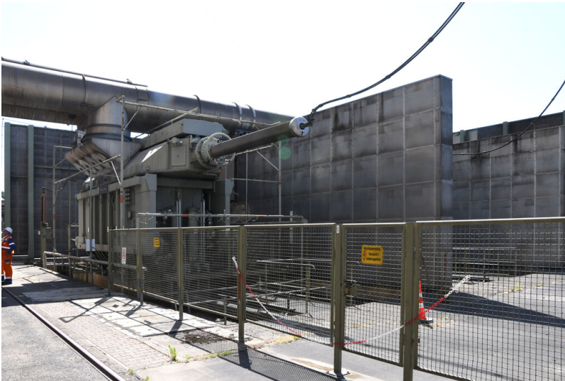
Kraftwerk Weisweiler: Maschinentransformatorpol Block G (21/380 kV, 266 MVA), Ansicht von Nordwesten; Foto: 13.06.2023 Fotograf/Urheber: Dr. Norbert Gilson
