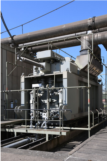
Kraftwerk Weisweiler: Einphasen-Maschinentransformator F 41 (21/380 kV, 133 MVA), Pol V, Ansicht von Osten; Foto: 13.06.2023 Fotograf/Urheber: Dr. Norbert Gilson
