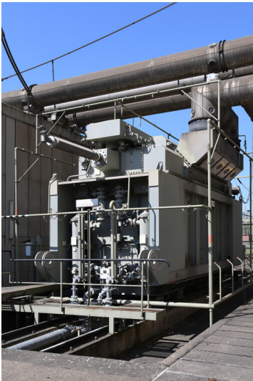
Kraftwerk Weisweiler: Einphasen-Maschinentransformator F 41 (21/380 kV, 133 MVA), Pol V, Ansicht von Osten; Foto: 13.06.2023 Fotograf/Urheber: Dr. Norbert Gilson
