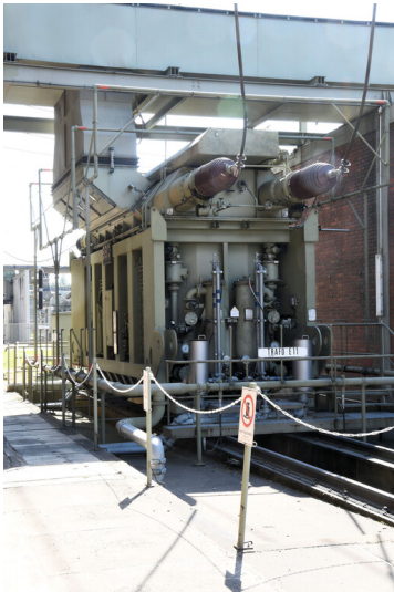
Kraftwerk Weisweiler: Maschinentransformator E 11 Block E (21/110 kV, Hersteller Brown, Boveri & Cie.), Ansicht von Nordwesten; Foto: 13.06.2023 Fotograf/Urheber: Dr. Norbert Gilson
