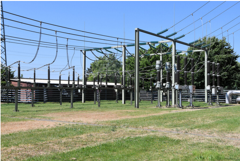
Kraftwerk Weisweiler: Freiluft-Schaltanlage 110 kV, Sammelschiene und Abgangsfeld von Trafo 11 (Mitte) mit Leistungsschaltern, Kombiwandlern und Trennern, Ansicht von Nordosten; Foto: 13.06.2023 Fotograf/Urheber: Dr. Norbert Gilson
