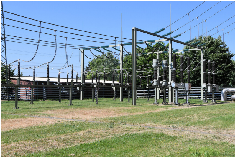
Kraftwerk Weisweiler: Freiluft-Schaltanlage 110 kV, Sammelschiene und Abgangsfeld von Trafo 11 (Mitte) mit Leistungsschaltern, Kombiwandlern und Trennern, Ansicht von Nordosten; Foto: 13.06.2023 Fotograf/Urheber: Dr. Norbert Gilson
