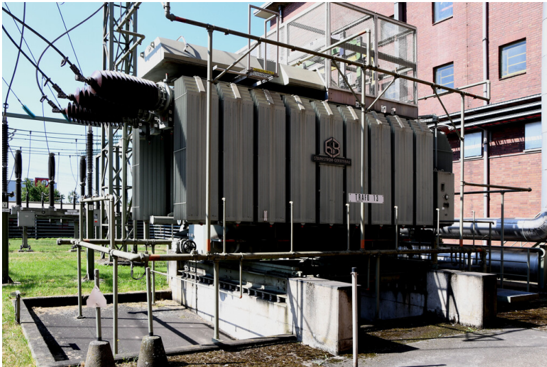
Kraftwerk Weisweiler: Eigenbedarfstransformator 13, Ansicht von Nordosten; Foto: 13.06.2023 Fotograf/Urheber: Dr. Norbert Gilson
