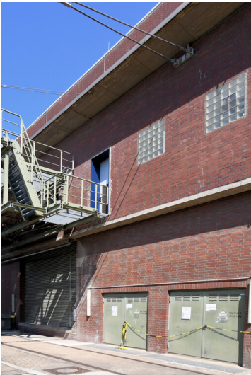
Kraftwerk Weisweiler: Schaltanlagenvorbau Block F, Ansicht von Südosten; Foto: 13.06.2023 Fotograf/Urheber: Dr. Norbert Gilson
