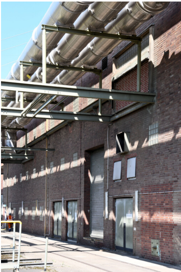
Kraftwerk Weisweiler: Schaltanlagenvorbau Block C, Ansicht von Südosten; Foto: 13.06.2023 Fotograf/Urheber: Dr. Norbert Gilson
