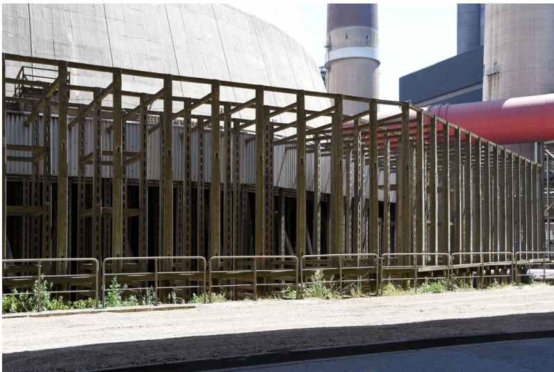
Kraftwerk Weisweiler: Kühlturm F, Vorbau mit Rieselementen, Ansicht von Nordwesten; Foto: 13.06.2023 Fotograf/Urheber: Dr. Norbert Gilson
