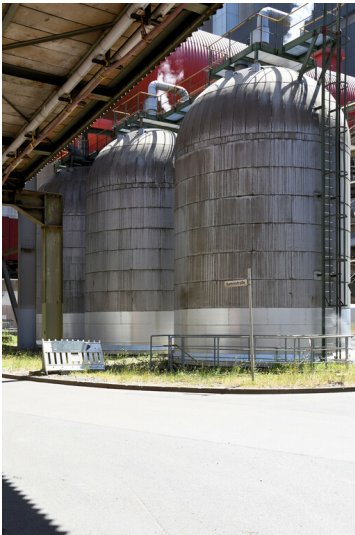
Kraftwerk Weisweiler: Notkondensatbehälter Block F, Ansicht von Osten; Foto: 13.06.2023 Fotograf/Urheber: Dr. Norbert Gilson
