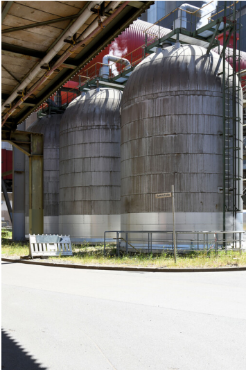
Kraftwerk Weisweiler: Notkondensatbehälter Block F, Ansicht von Osten; Foto: 13.06.2023 Fotograf/Urheber: Dr. Norbert Gilson
