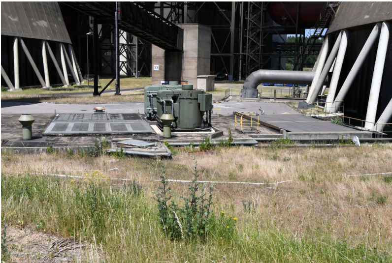
Kraftwerk Weisweiler: Kühlwasser-Pumpenhaus Block H, Ansicht von Süden; Foto: 13.06.2023 Fotograf/Urheber: Dr. Norbert Gilson
